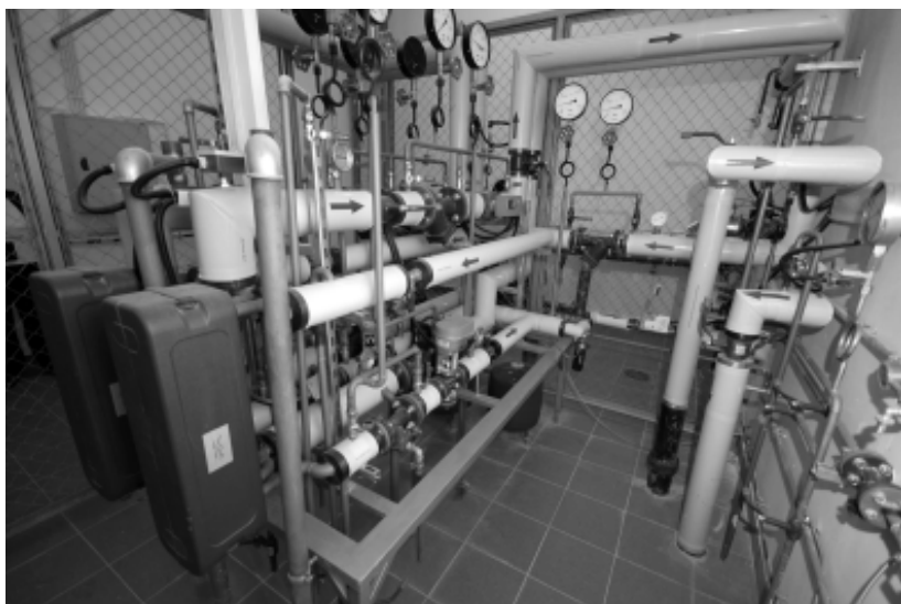
Węzeł ciepłowniczy. Fot. archiwum MEC
