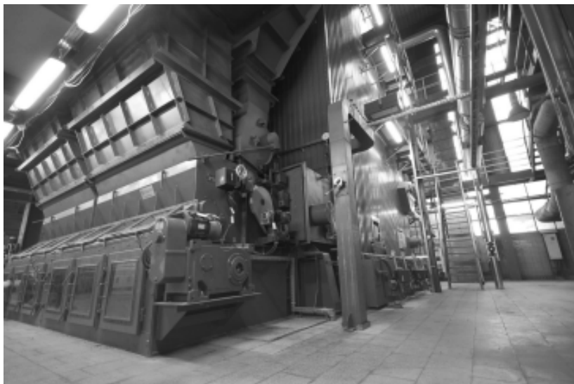
Kocioł WR25 w kotłowni DPM - fot. archiwum MEC
